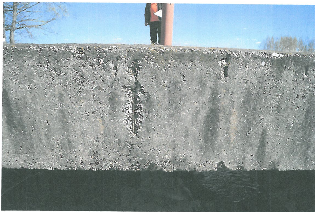
Fot. 10. Charakterystyczne uszkodzenia belek podporęczowych. Ubytki betonu, korozja odkrytego zbrojenia, wegetacja porostów.
