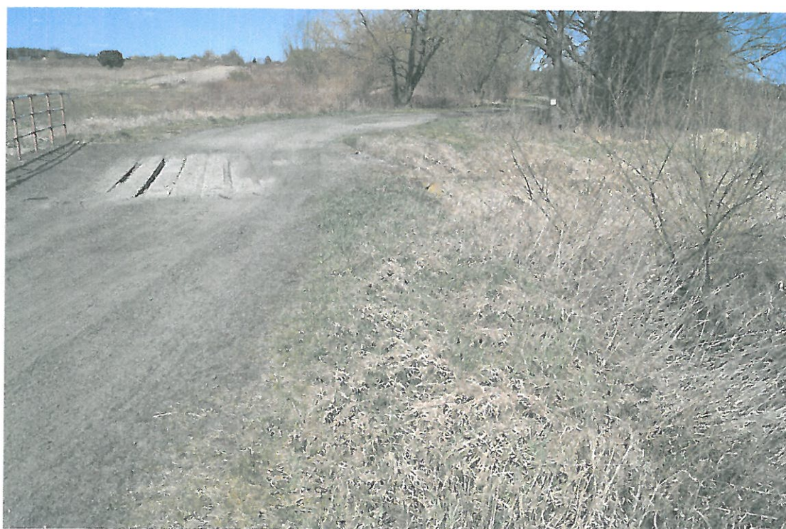
Fot. 6. Zawyżone pobocza gruntowe na dojazdach do mostu utrudniające odwodnienie powierzchniowe nawierzchni jezdni.
