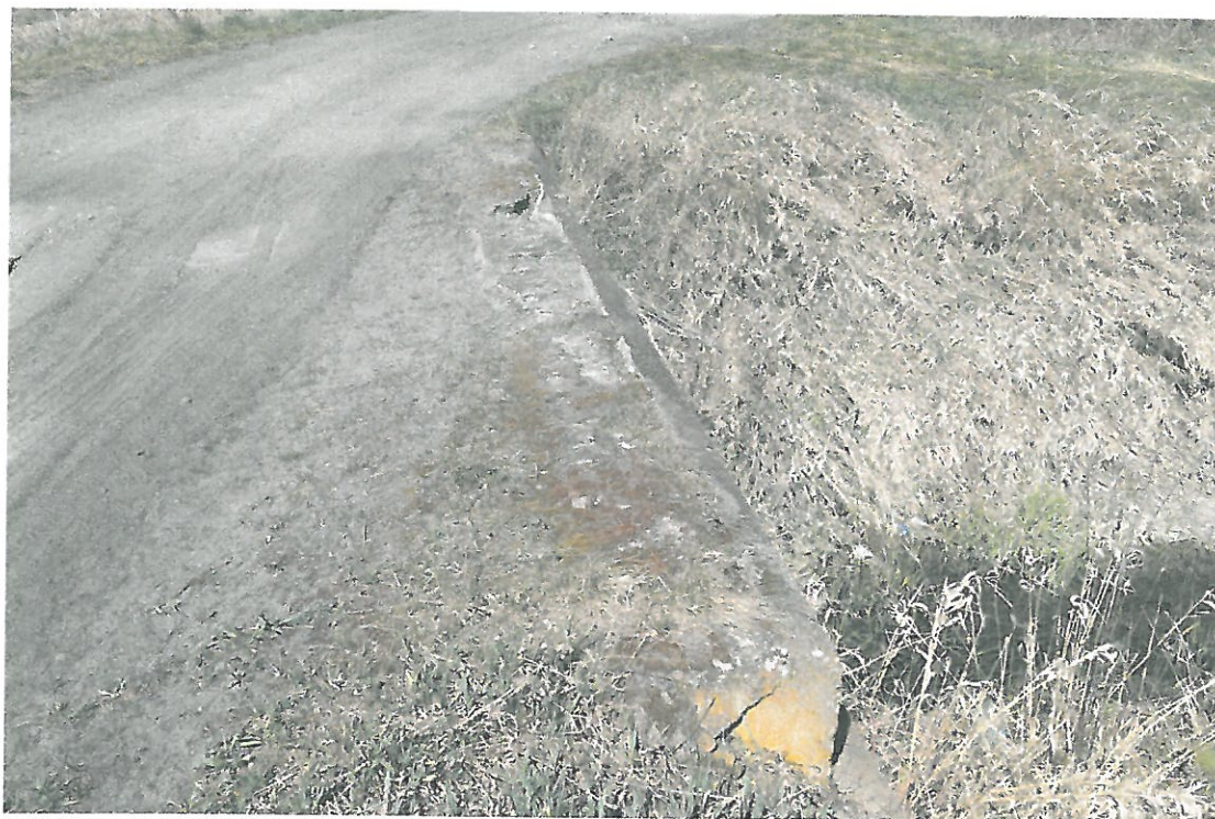
Fot. 9. Brak balustrady (prawdopodobnie w wyniku kradzieży) na belce podporęczowej od strony wody dolnej.
