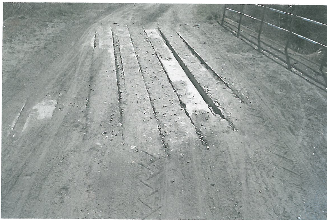
Fot. 7. Całkowicie zniszczona nawierzchnia jezdni, beton ochronny prefabrykowanych belek ustroju nośnego oraz izolacja. Od strony prawobrzeżnej z jezdni wystają pręty zbrojeniowe.
