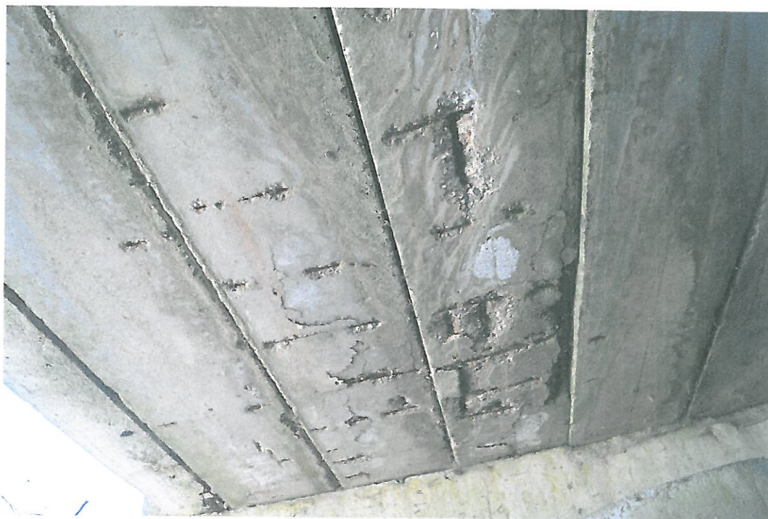
Fot. 11. Charakterystyczne uszkodzenia na spodniej powierzchni prefabrykowanych belek ustroju nośnego. Ubytki betonu, korozja zbrojenia, osady i wykwity, ślady po intensywnych przeciekach, wegetacja porostów.
