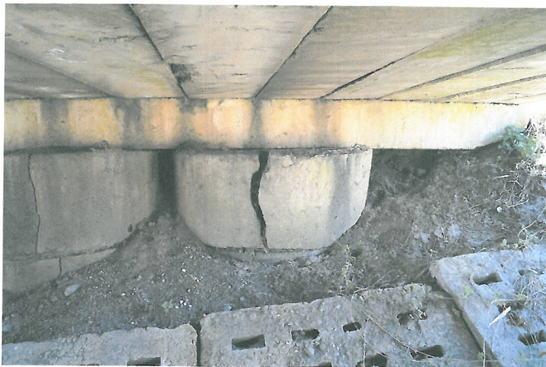
Fot. 13. Fragment przyczółka prawobrzeżnego. Pęknięcia kręgów betonowych, zarysowania belki oczepowej, ślady po intensywnych przeciekach.
