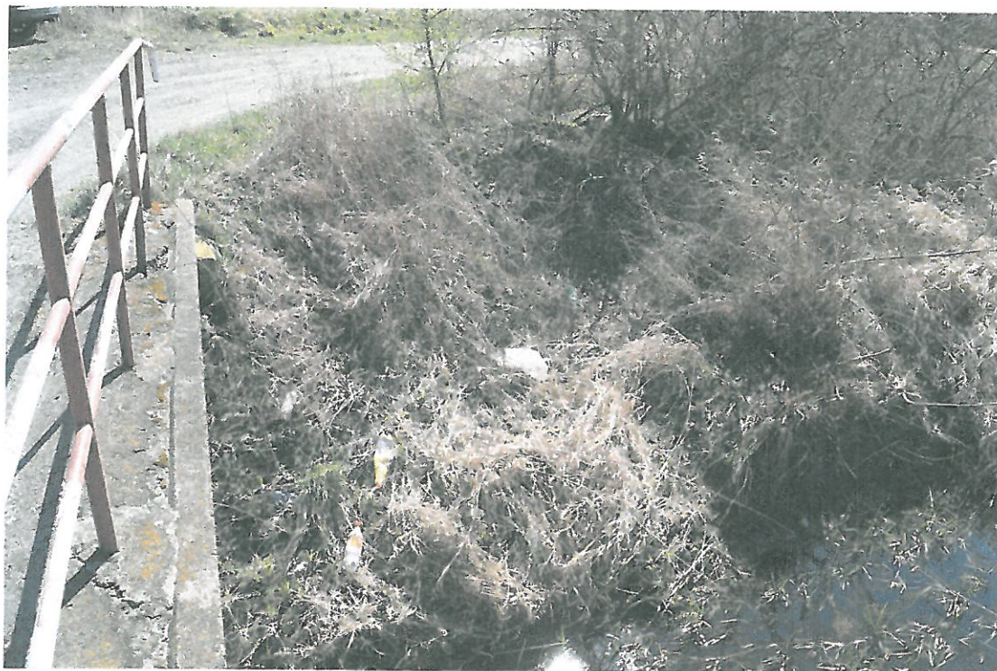
Fot. 5. Charakterystyczna sucha roślinność po intensywnej wegetacji na skarpach przy przyczółkach od strony wody górnej i dolnej. Zanieczyszczenie skarp.
