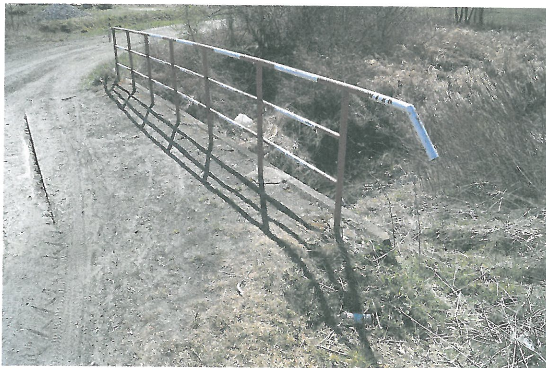
Fot. 8. Balustrada od strony wody górnej. Miejscowa korozja powierzchniowa, uszkodzenie powłok malarskich, lokalne obluzowanie zamocowania słupków.
