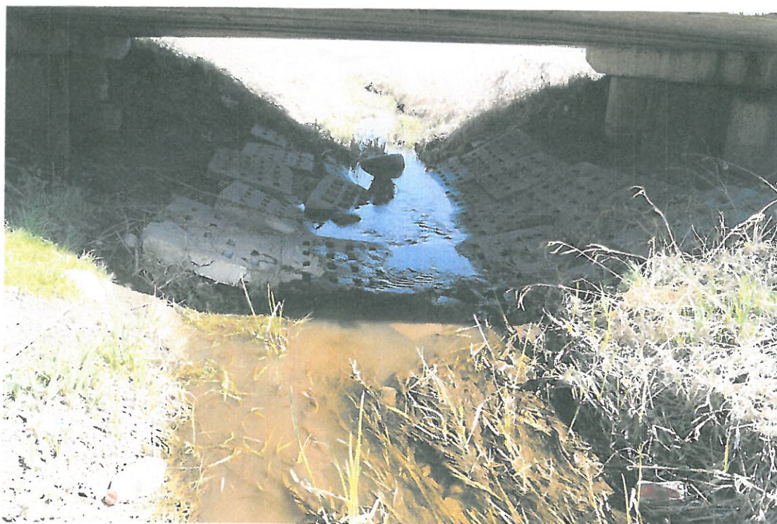
Fot. 14. Widok od strony dopływu na betonowe umocnienia koryta cieku. Przemieszczenia płyt betonowych, ubytki\wymycia gruntu, wegetacja roślinności.
