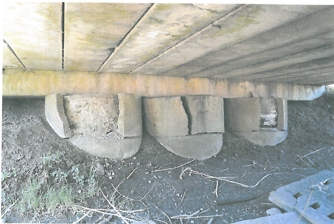
Fot. 12. Widok na przyczółek lewobrzeżny. Ubytki i pęknięcia kręgów betonowych, silna korozja betonu wypełniającego kręgi. Zarysowania na belce oczepowej.
