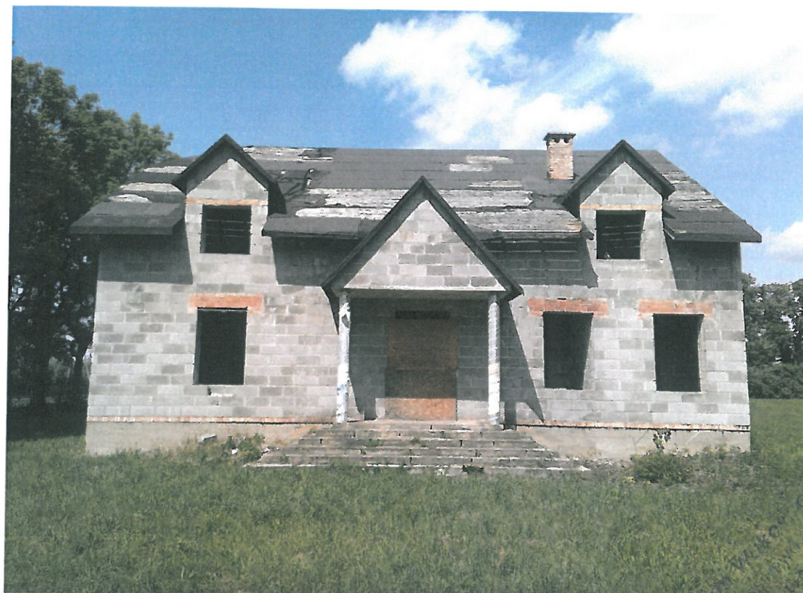
Fot. 1 Elewacja południowa – frontowa. Na połaci dachowej liczne ubytki pokrycia papowego.
