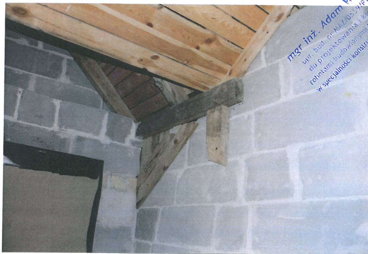
Fot. 18 Widoczne zamocowanie oparcie płatwi lukarny na kawałku krokwi, który to przymocowany jest do ściany za pomocą jednego gwoźdź wbitego w gazobeton.
