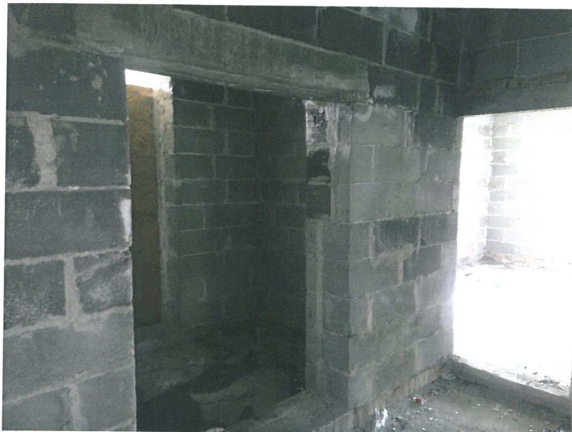
Fot. 7 Jedna ze ścian konstrukcyjnych budynku jest wyraźnie grubsza od pozostałych – 1,5 grubości bloczka. Widoczne przesunięcia ułożenia bloczków gazobetonowych od połowy wysokości muru.
