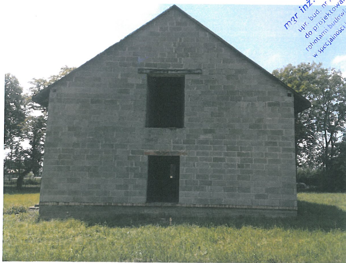
Fot. 4 Elewacja wschodnia – boczna. Dach połąć dachu w przypadku ocieplenia ścian styropianem, wymaga przedłużenia.
