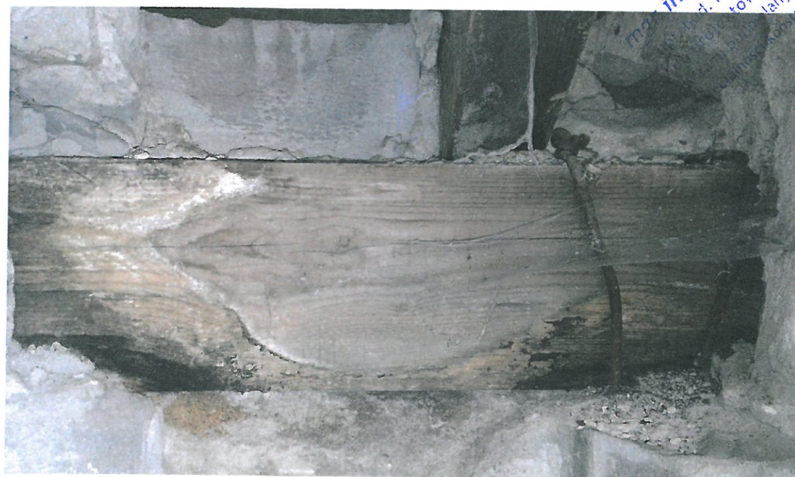
Fot. 16 Murlata leży bezpośrednio na wieńcu, bez odizolowania od muru i jest obmurowana. Mocowanie murlaty za pomocą zakręconego pręta \phi 6\text{mm} , jest niedopuszczalne.
