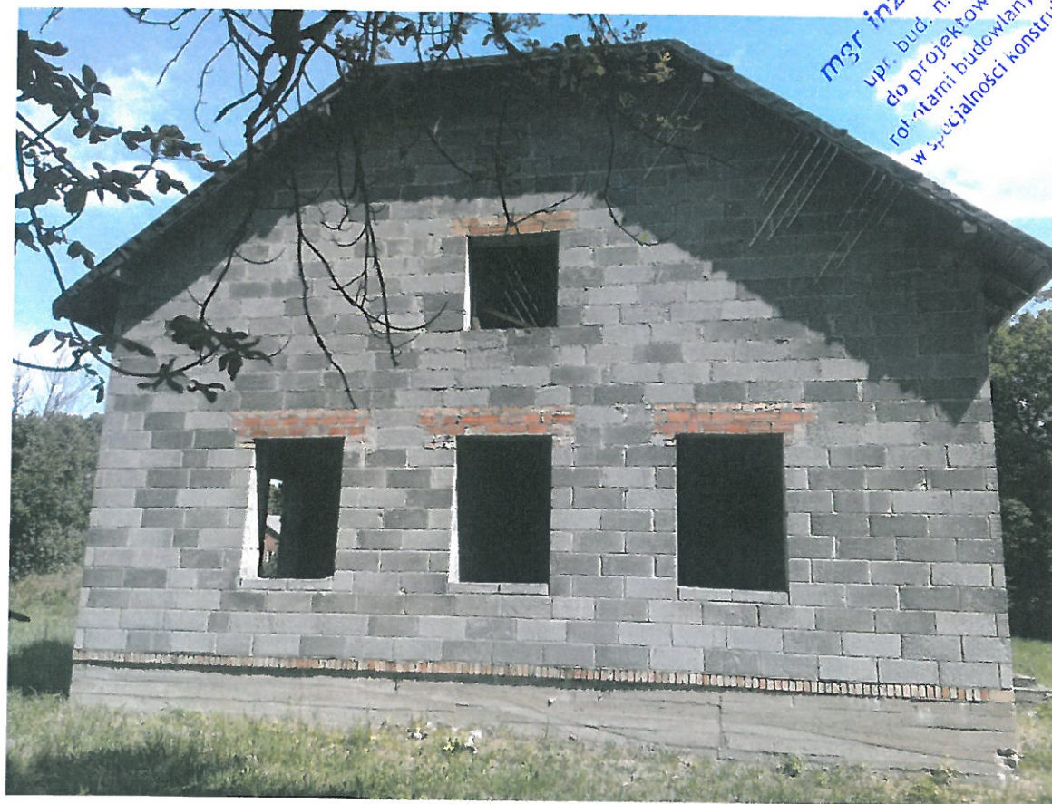
Fot. 2 Elewacja zachodnia. Połacie dachu wysunięte poza lico muru, czego nie wykonano po stronie elewacji wschodniej.
