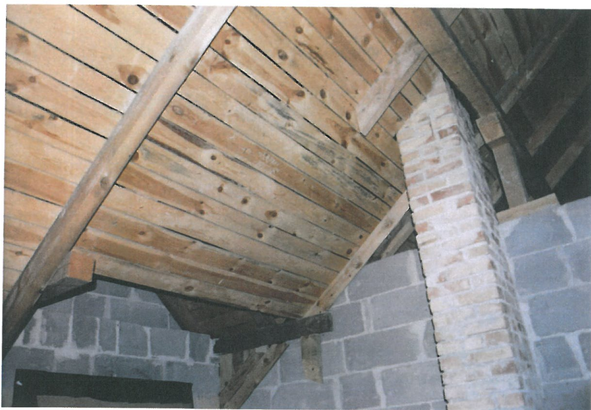
Fot. 17 Lukarna dachowa – brak wymianu, krokiew środkowa lukarny wyraźnie za krótka, płatów lukarny oparta na dziwnym ścinku krokwi.. Stolec podpierający płatów połączy dachu oparty bezpośrednio na ścianie działowej.
