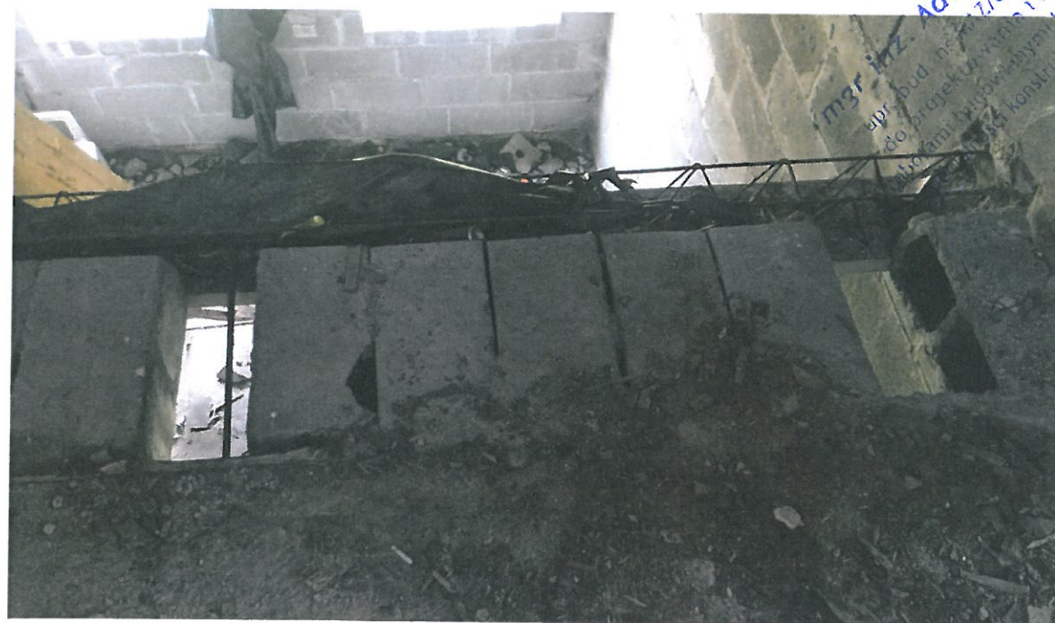
Fot. 12 Szacht klatki schodowej widoczny z poddasza. Strop w stanie surowym, bez warstwy nadbetonu, brak pustaków stropowych, a te które są ułożone często są uszkodzone.
