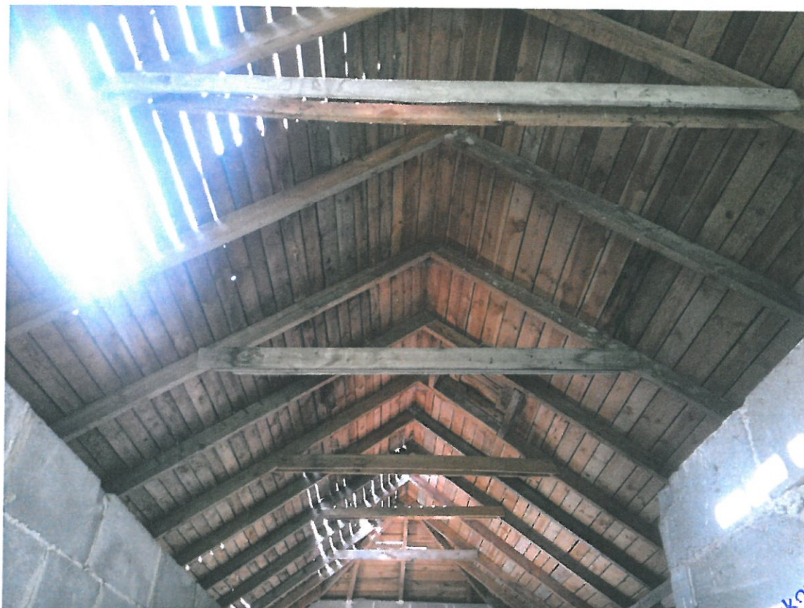
Fot. 13 Widok ogólny z korytarza na poddaszu na wieżbę dachową. Kleszcze wykonano z desek mocując na gwóźdź do krokwi. Kleszcze są za wysoko, a poza tym nie spinają wszystkich par krokwi. Liczne prześwity pomiędzy deskowaniem świadczą o braku pokrycia dachowego.
