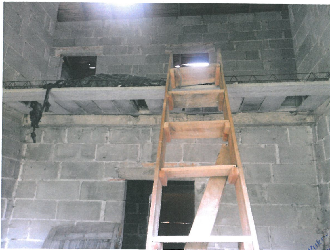
Fot. 11 Widok na poddasze z szachtu klatki schodowej – brak schodów.
