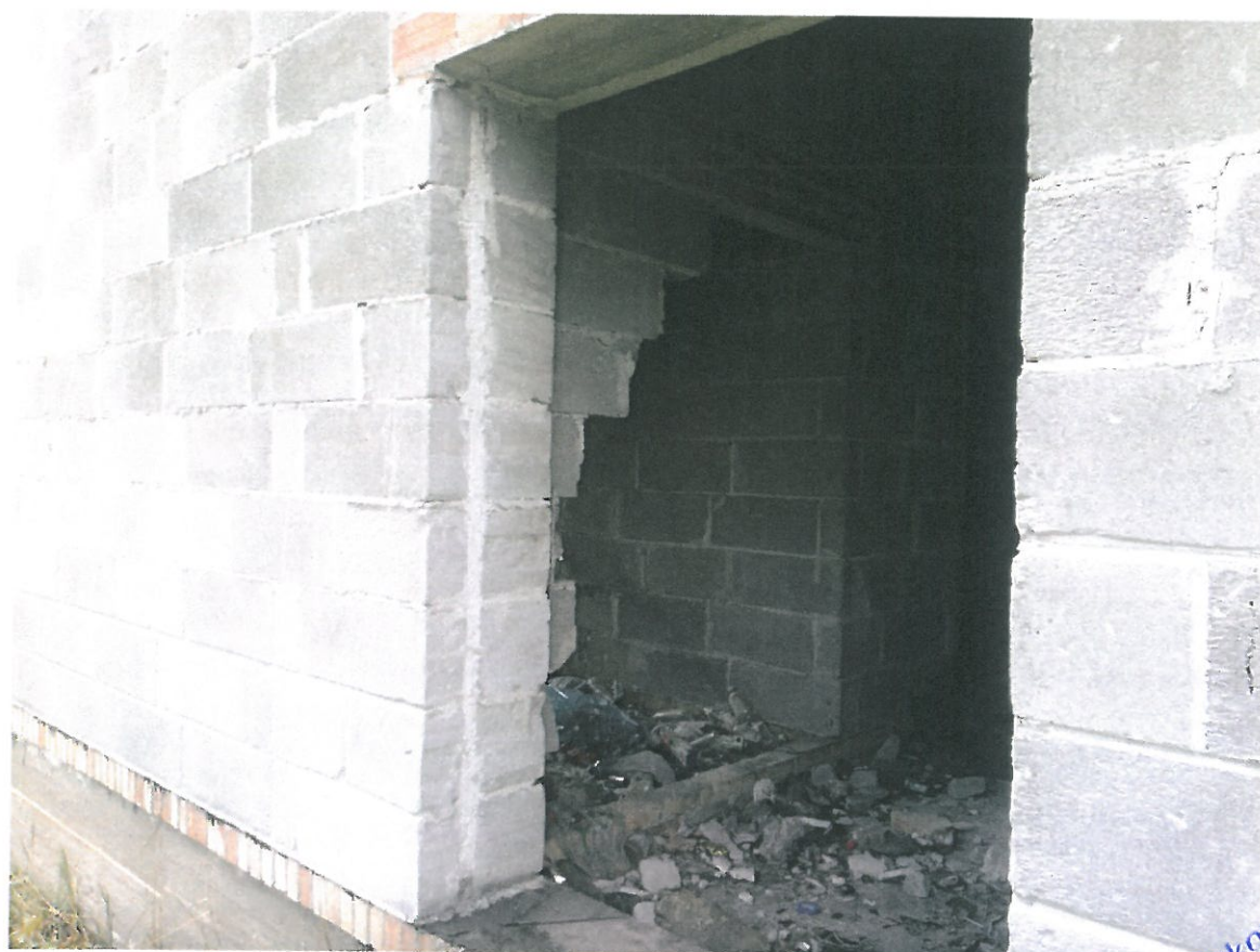
Fot. 5 Widok na wnętrze budynku od strony wschodniej. Widoczna częściowo zdewastowana ściana działowa.
