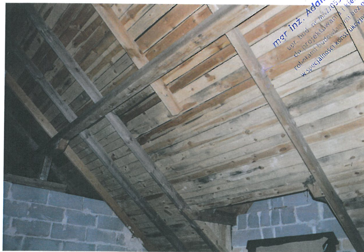
Fot. 20 Kolejna lukarna, błędnie wykonana. Ty również widać słupek podpierający płatów dachową oparty na ścianie działowej.
