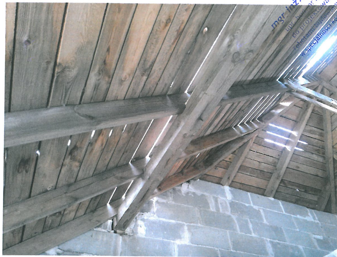
Fot. 14 Widoczne deskowanie dachu. Na deskach widoczna sinizna.
