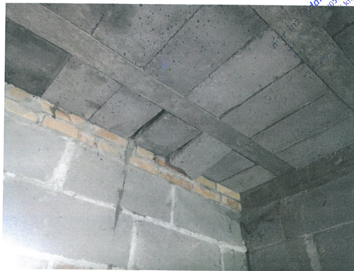
Fot. 10 Niektóre z pustaków stropowych (garów) uległy zniszczeniu.
